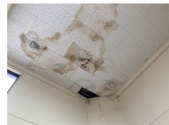
漏水しているようす
