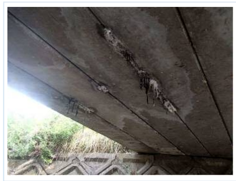
漏水・遊離石灰
