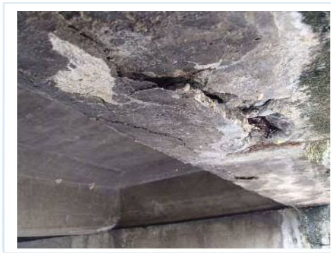
コンクリートの浮き
